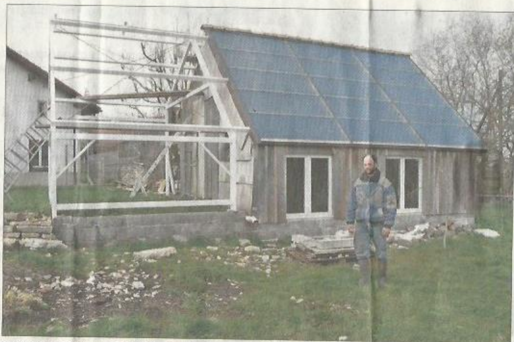
Stéphane Berberat a construit lui-même les panneaux solaires posés sur le grenier devant sa ferme. PHOTO MNI
