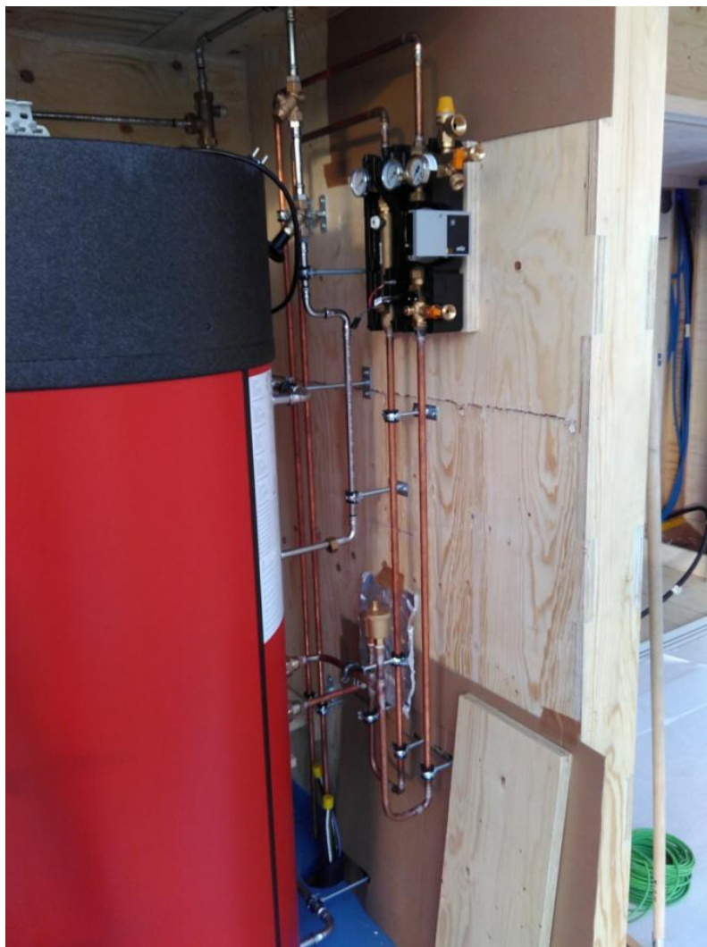
FIGURE 23 – Groupe solaire sans isolation
