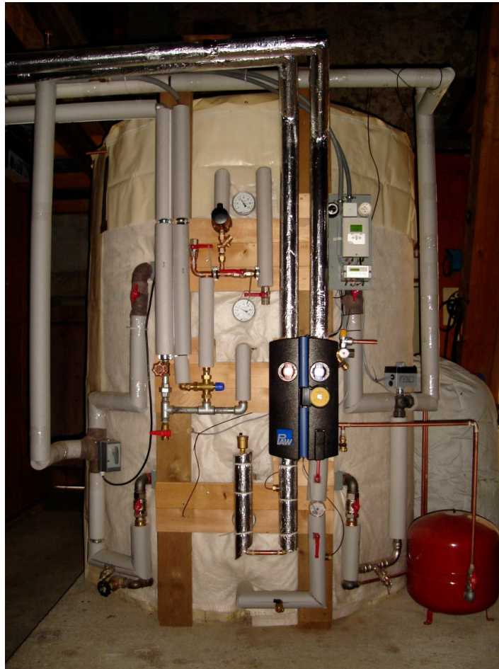
Figure 5 : Détail de l'accumulateur une fois complètement équipé.
