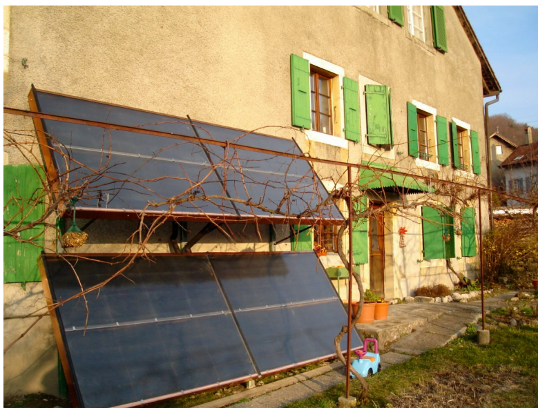
Figure 3 : panneaux solaires implantés en façade.
